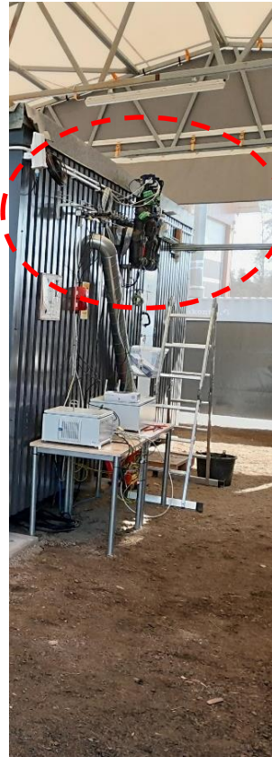
Kaasuanalysointilaitteet (H 2 , CH 4 , CO 2 )
