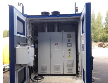
Vetyä voidaan tuottaa elektrolyysilaitteistolla (kuvassa). Kuva: VTT
